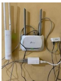
Gambar 6. Pemasangan Router TP-Link EAP 110
